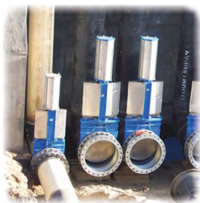
Instalace na směšovací komoru
